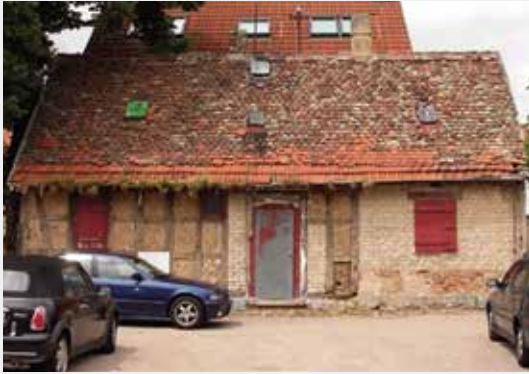
Vor der Sanierung gab der historische Bau des Heimatmuseums in Raunheim einen recht traurigen Anblick ab ....
